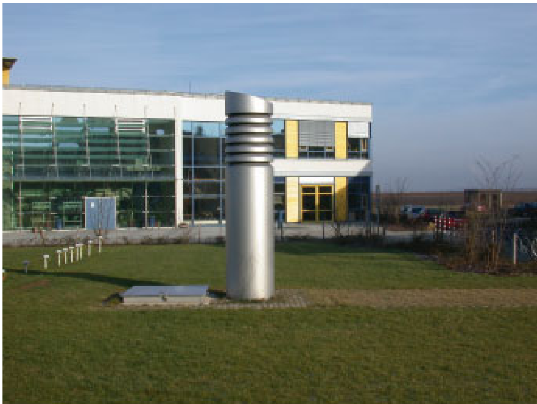
Bild 1.3 Ansaugturm des Luft-Erdwärmetauschers Auditorium
