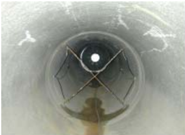
Bild 1.29 Stehendes Wasser in den Fugen zwischen zwei Rohrsegmenten
