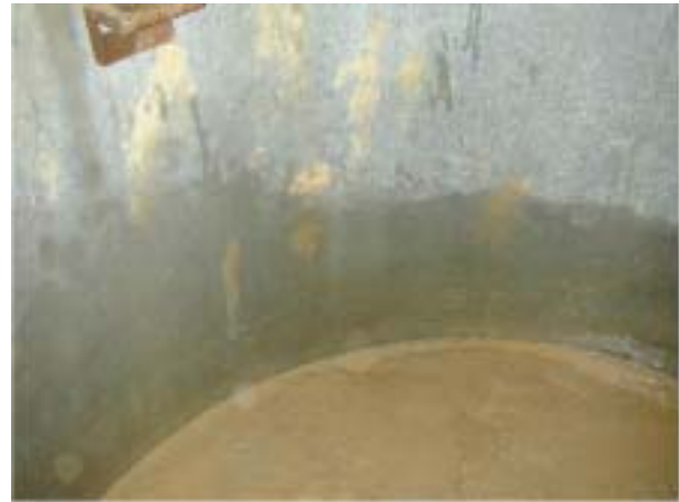
Bild 1.24 Nach dem Abpumpen des Wassers spiegelt der feuchte Rand die Wasserstandshöhe im Kondensatsammelschacht wider
