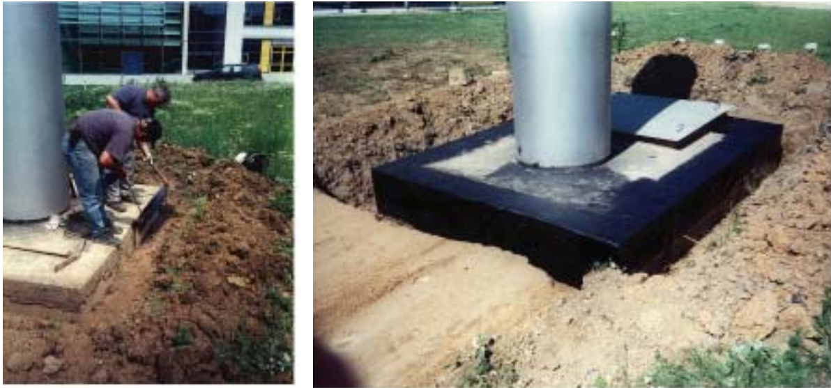
Bild 1.313 Ansaugschacht vor den Abdichtungsarbeiten (links) und nach dem Abdichten mit Bitumen (rechts)
