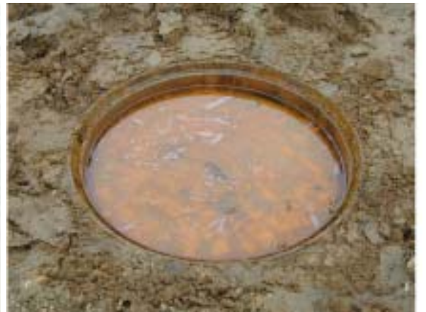
Bild 1.30 Stehendes Wasser in einer der Schacht-abdeckungen, verursacht durch nachträgliches Auffüllen des Erdreiches
