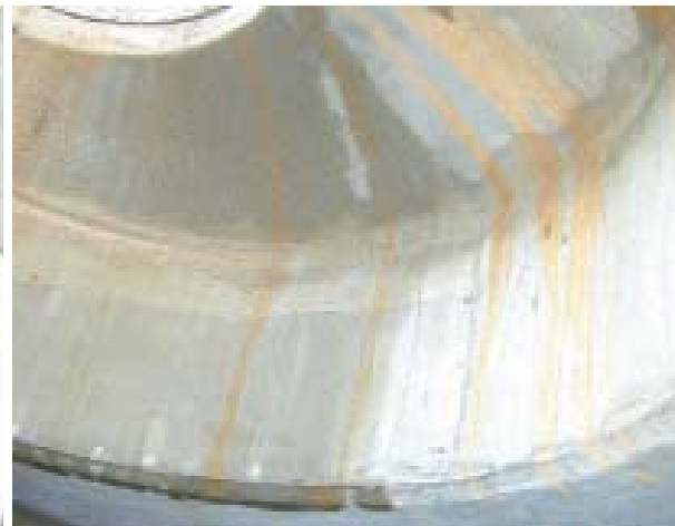
Bild 1.26 Fließspuren an den Fugen im Kondensatwasserschacht
