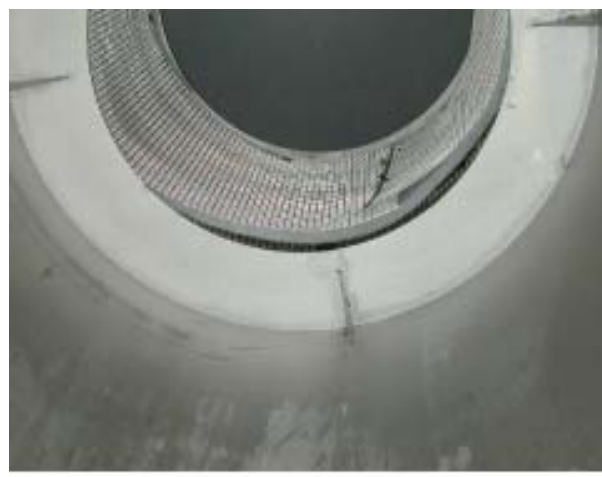
Bild 1.30 Spalt zwischen Luftfilter und Ansaugschacht durch falsch eingesetztes Filterelement
