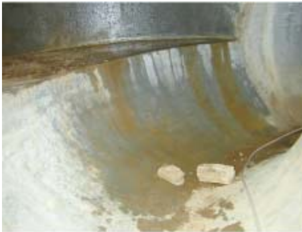
Bild 1.27 Fließspuren auf dem Boden des ersten Revisionschachtes
