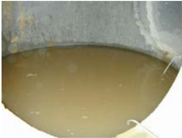
Bild 1.23 Stehendes Wasser im Kondensatsammelschacht
