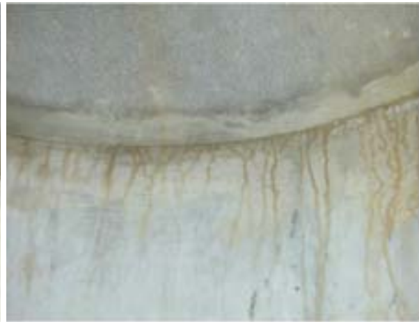
Bild 1.28 Wassereindringspuren an den Deckelfugen des zweiten Revisionschachtes
