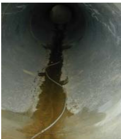
Bild 1.291 Wasser im Verbindungsrohr zwischen Revisionschacht 1 und Kondensatschacht
