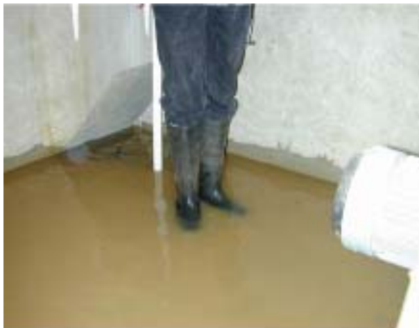
Bild 1.25 Stehendes Wasser im Ventilatorschacht
