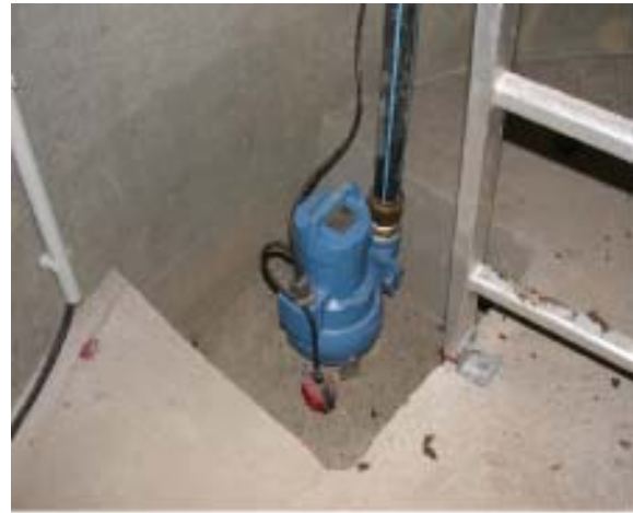
Bild 1.35 Nachträglich eingebauter Kondensatsammelschacht mit fest eingebauter Kondensatpumpe
