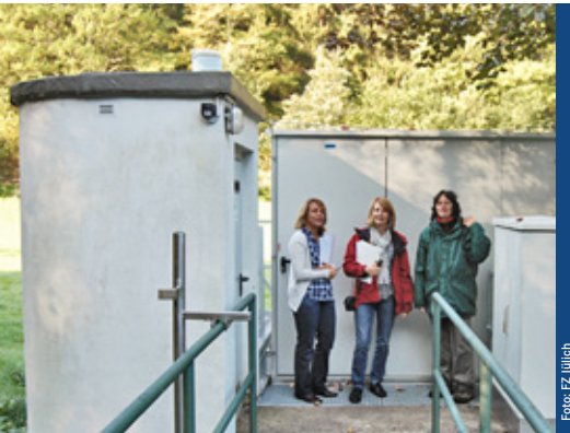
Erfolgreiche Abnahme: die um den klimatisierten Messcontainer erweiterte Pegelanlage „Erkensruhr“
